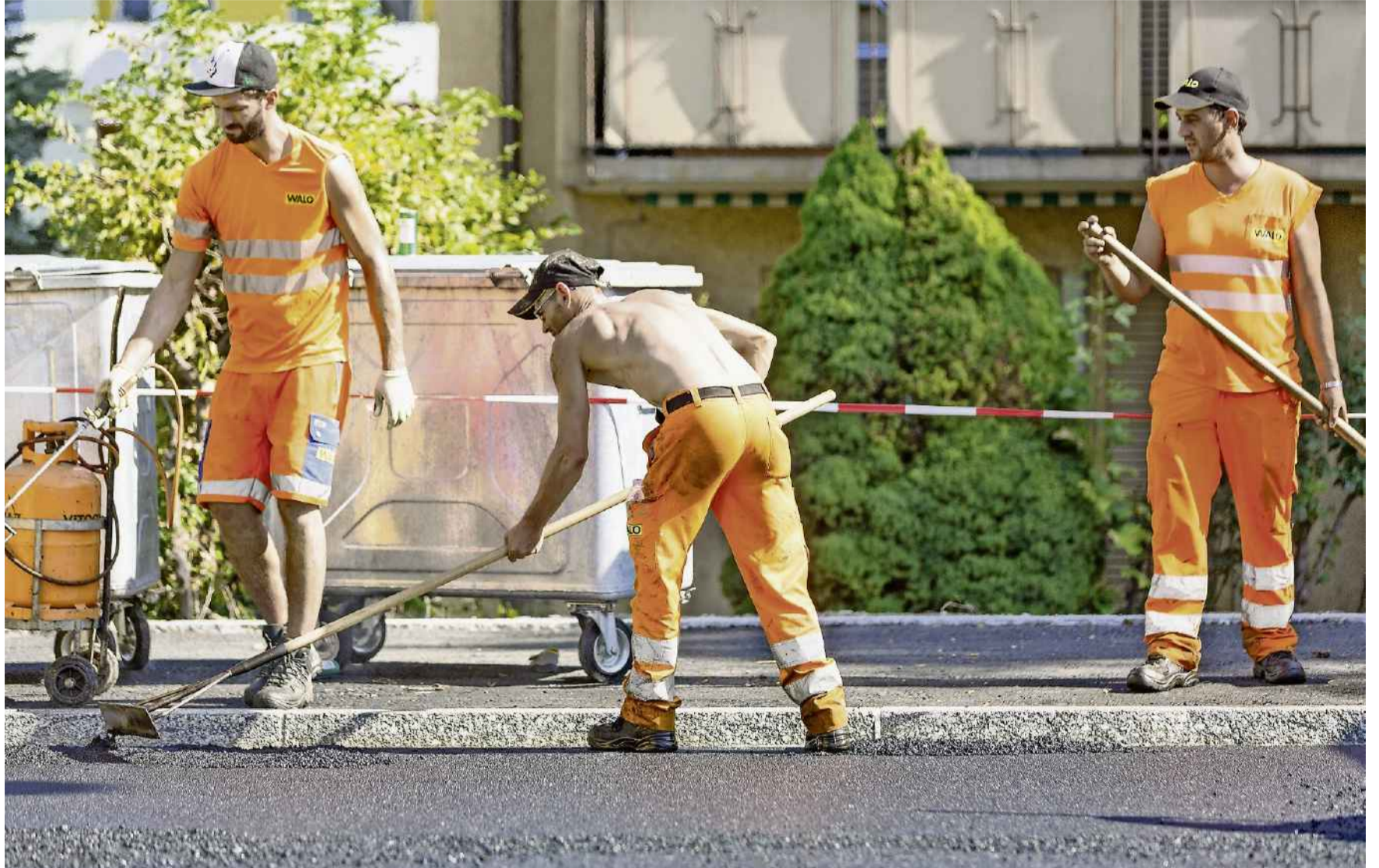
In brütender Hitze wurde letztes Jahr die neue Schönenwerdkreuzung gebaut. Ein Teil der Mühe ist nun für die Katz: Der Belag wird wieder aufgerissen. ARCHIV/C. ISELI
